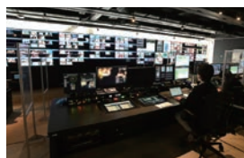
マスターコントロールルーム
